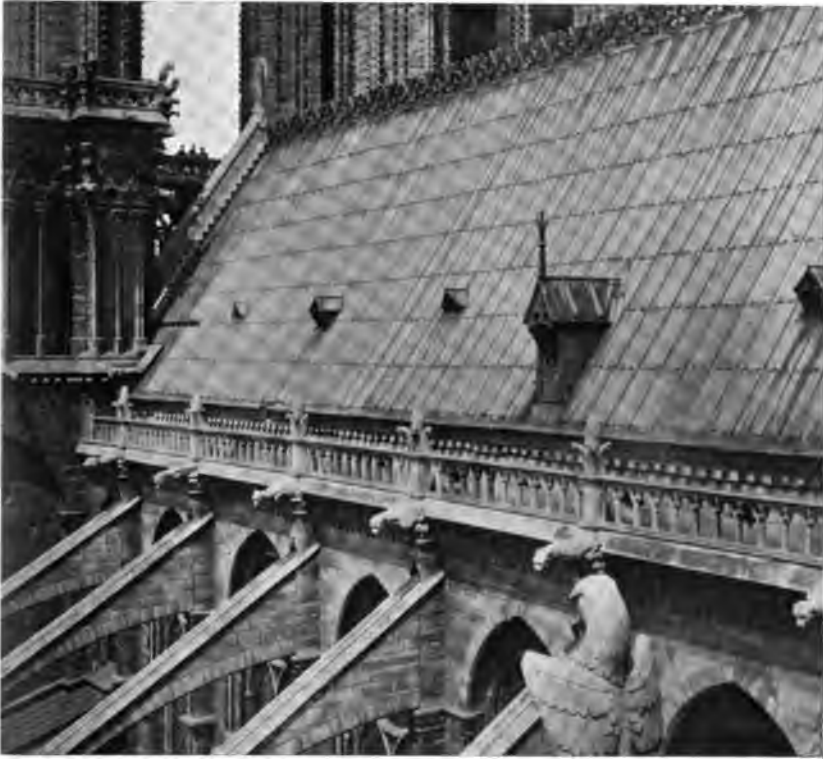
Fig. 113. — Appui continu en pierre à la base des combles de la cathédrale de Paris.
